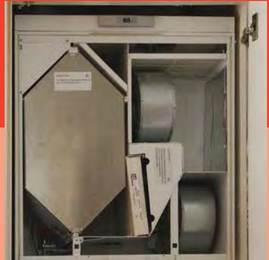
Isı değiştiricisi görünen havalandırma ünitesi
